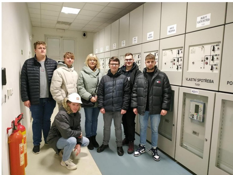
Obrázek 104 Rozvodna Plzeň Černice II
