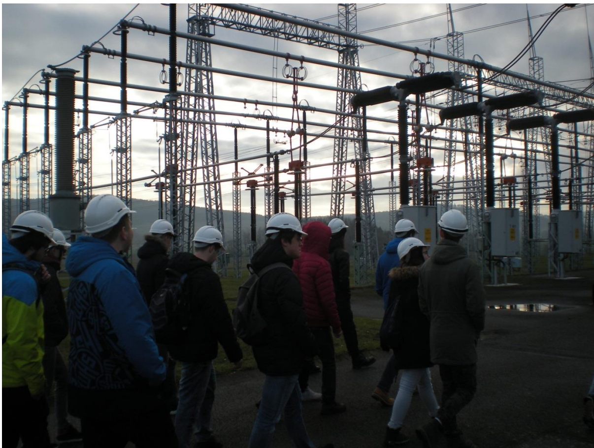
Obrázek 117 Rozvodna Přeštice IV
